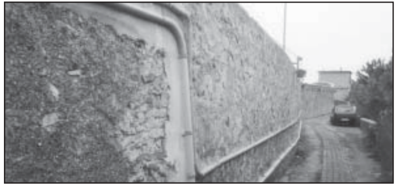
I tubi su un muro cinquecentesco in salita Superiore Salvator Rosa
